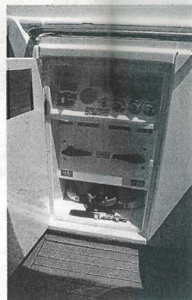
Un mueble estanco junto al puesto de gobierno contiene los cortes de baterías y otros controles.
